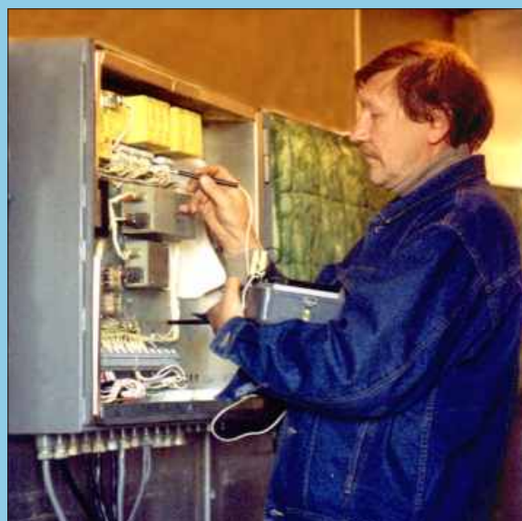
Шкаф контроллера. Наладка на объекте.
